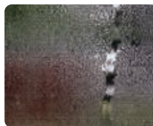
単板ガラス(5ミリ)を使用した場合結露が発生しています
