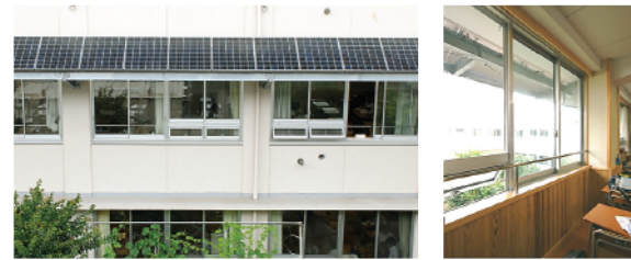
（使用したガラス） ● 教室南面窓：ペアガラス（フロートガラス6ミリ+中空層6ミリ+フロートガラス6ミリ） ● 廊下パーティション：エコガラス（Low-Eガラス4ミリ+中空層4ミリ+フロートガラス4ミリ）、ペアガラス（強化ガラス4ミリ+中空層6ミリ+強化ガラス4ミリ）
