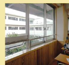
教室の窓には一枚板のペアガラスを採用。夏の直射日光を遮る深い庇は、太陽光発電パネルを兼ねている。腰壁は廊下パーティション同様に断熱した。左下に見えるのはナイトパーズの突出し窓
