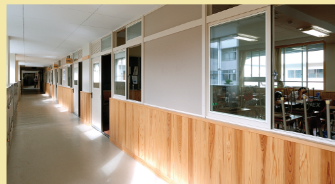
廊下と教室を隔てるパーティション。木材を使った腰壁とエコガラスの窓、高気密のアルミサッシが廊下の冷気を遮断する
